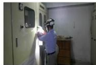
每月檢視高低壓設備狀況，確保用電安全
